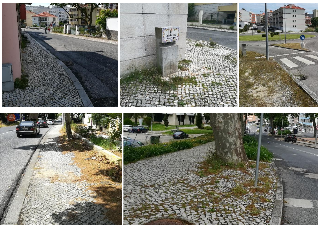
Figura 21. Exemplos de pavimento degradado e espaços pouco apelativos para a circulação pedonal
